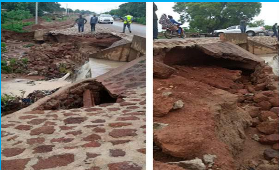
Etat de dégradation des travaux du 11 décembre 2020 à Niangoloko (Août 2021)
