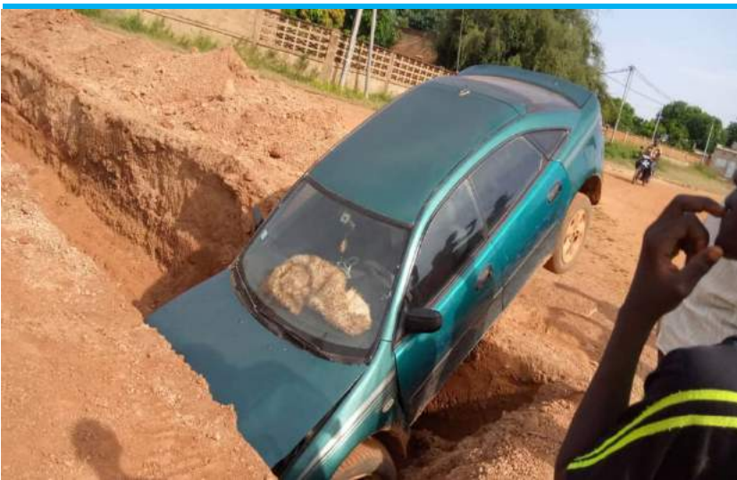
Un accident dans une rue à Tenkodogo en 2019 (causé par l'absence de ruban de signalisation)
